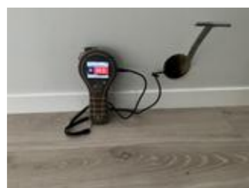
Fuktmålingen viser 25,5 vekt%
