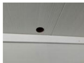
Bildet viser hull i tak.
