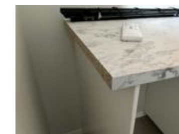
Manglende dekklist på benkeplate.
