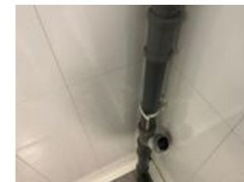
Manglende innfestning av avløpsrør.
