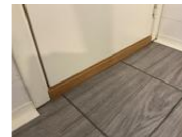
Bildet viser manglende tilluftsspalte under dør.
