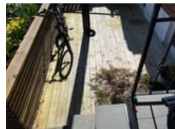
Manglende rekkverk i trapp
