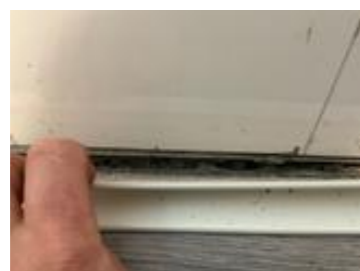
Ufagmessig utførelse av baderomsplater.
