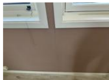
Bildet viser riss/sprekk i vegg.
