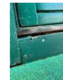
Manglende beslag under dør.
