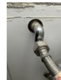
Manglende tetting rund rørgjennomføring for dusjkabinett.
