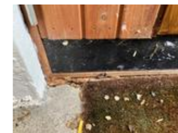
Manglende beslag under dør.
