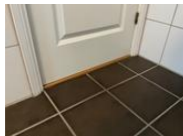
Bildet viser manglende tilluftsspalte under dør.
