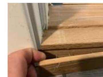
Manglende membranoppbrett ved dørterskel.
