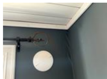
Bildet viser luftbobler i tapet.
