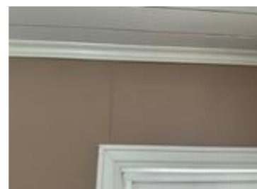
Bildet viser riss/sprekk i vegg
