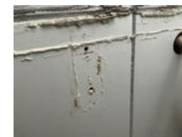
Hull i vegg bak dusjkabinett
