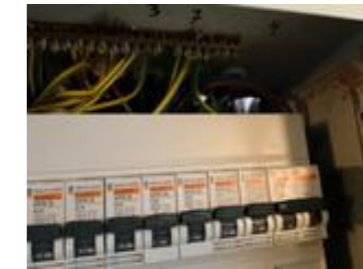
Hull i sikringskapet.
