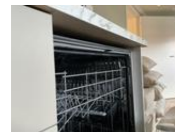
Manglende fuktsikring av benkeplaten ved oppvaskmaskin.
