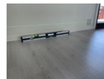
Bildet viser området hvor det største høydeavviket er registrert i loftstuen.
