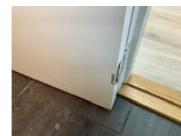
Bildet viser løs hengsle.
