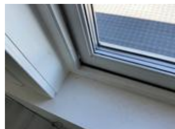
Bildet viser glippe mellom vindu og vinduskarm.
