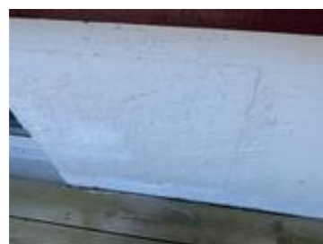
Bildet viser riss i murpuss til grunnmur
