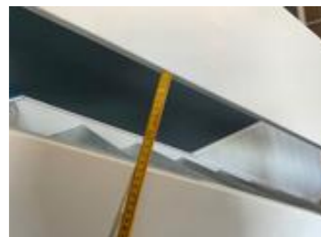
Åpning mellom rekkverkspiler som er målt til 27 mm.
