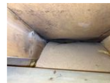
Manglende luftespalte mellom isolasjon og undertak.
