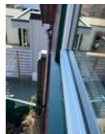
Bildet viser glippe mellom utvendig listverk og vinduskarm.
