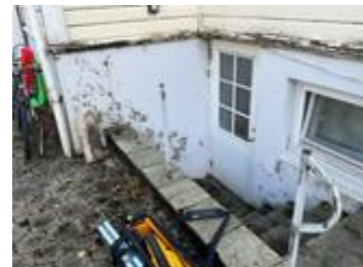
Manglende rekkverk i trapp til kjeller.
