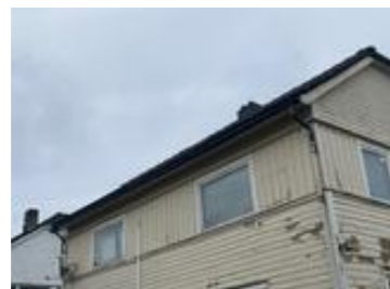
Takrenne med nedbøyninger.
