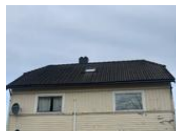
Manglende snøfanger på taket
