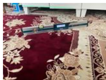
Bildet viser målinger av høydeavvik i gulv i 1. etasje.
