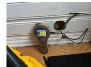
Fuktmålingen viser 17,3 vekt%
