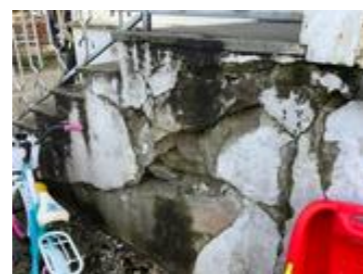
Sprekker i trapp til inngangspartiet.
