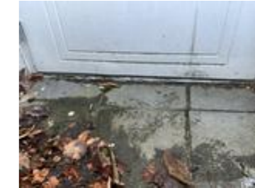
Oppsprukket fuge i bunn av dør.
