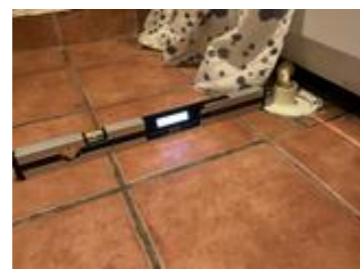
Manglende fall mot sluk.
