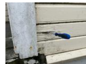
Kledning med spredt råteskade
