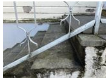
Åpninger i rekkverk til utvendig trapp som er større en dagens krav.
