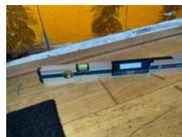
Bildet viser målinger av høydeavvik i gulv i kjeller.
