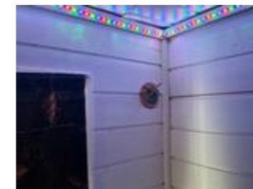
Ledninger som ikke er tilstrekkelig tildekket.
