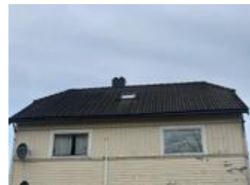
Manglende snøfanger på taket
