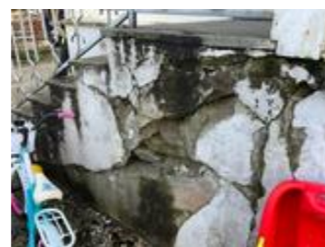
Sprekker i trapp til inngangspartiet.
