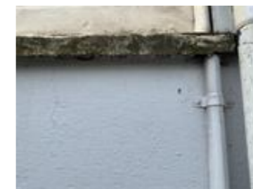
Manglende lufting for kledning.
