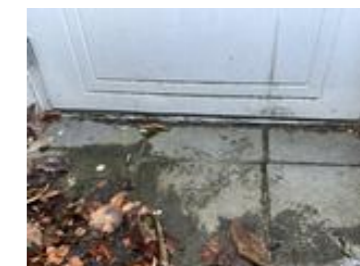
Oppsprukket fuge i bunn av dør.
