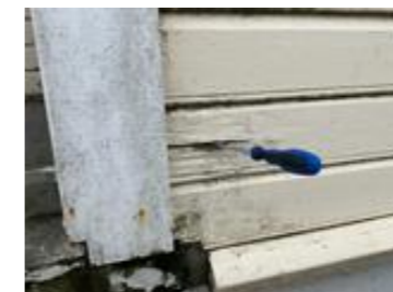
Kledning med spredt råteskade
