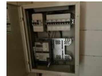
Oversiktsbilde av sikringsskap for 1. etasje.
