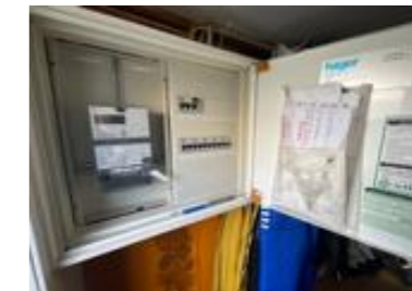
Oversiktsbilde av sikringsskap for hybel.
