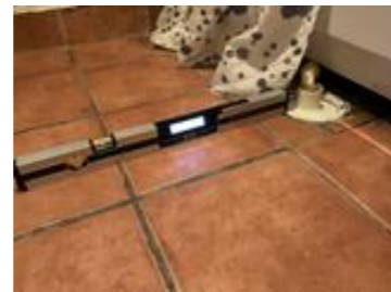
Manglende fall mot sluk.
