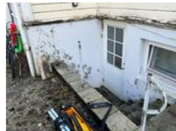
Manglende rekkverk i trapp til kjeller.
