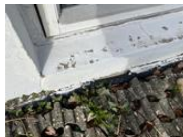
Manglende klemlist på fuksikring av grunnmur.
