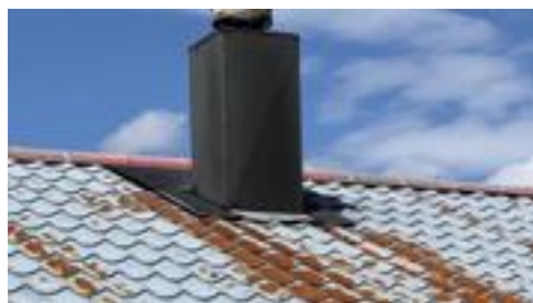
Eksempelbilde av slitasjegrad og rust.
