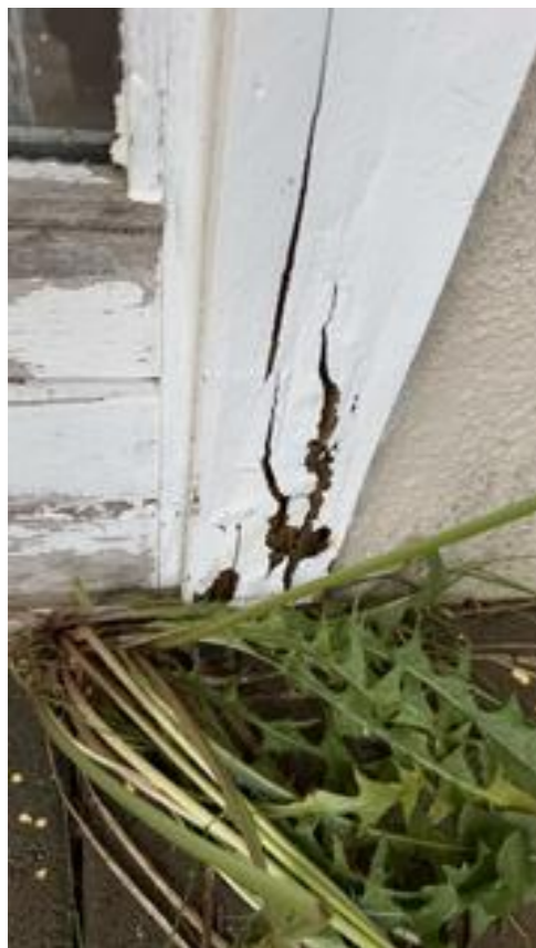
Eksempelbilde av råteskade og malingsavfluss.
