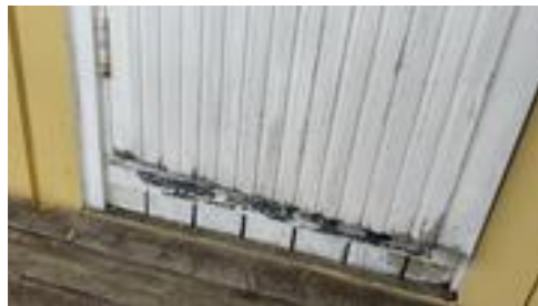
Eksempelbilde av slitasjegrad på verandadør.
