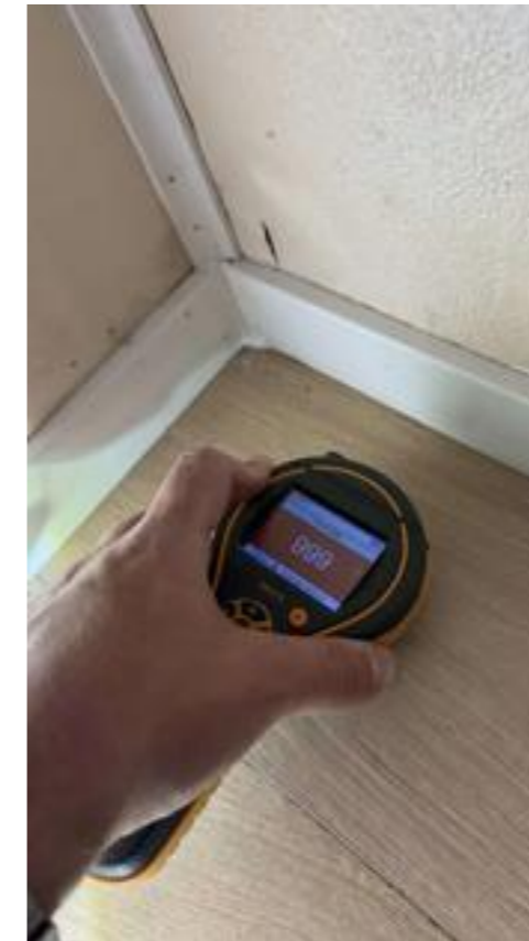
Eksempelbilde av indikasjoner på fukt.
