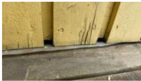
Eksempelbilde av råteskade.
