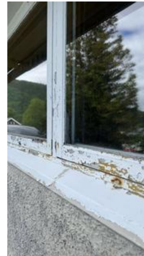
Eksempelbilde av slitasjegrad på vindu.
