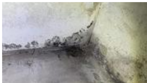
Eksempelbilde av muggsopp i vegg mellom bod og gang.
