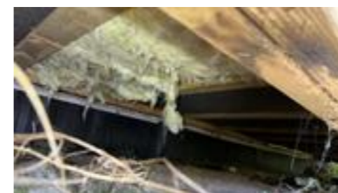
Eksempelbilde av manglende stubbloftsplate.
