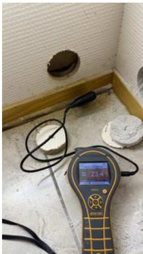
Eksempelbilde av fuktmåling over faregrensen for utvikling av sopp/ råteskader.
