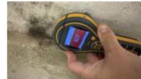
Eksempelbilde av indikasjoner på fukt.
