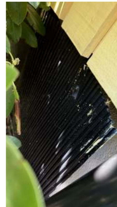
Eksempelbilde av manglende topplst på grunnmursplast.
