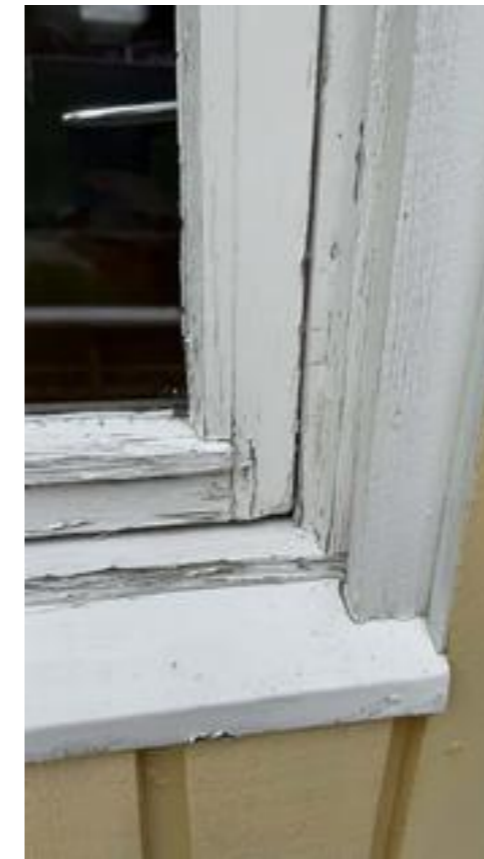
Eksempelbilde av slitasjegrad på vindu.
