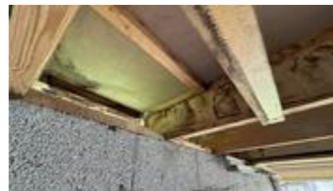
Eksempelbilde av fuktmerker.
