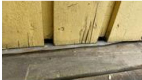
Eksempelbilde av råteskade.
