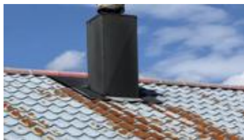
Eksempelbilde av slitasjegrad og rust.
