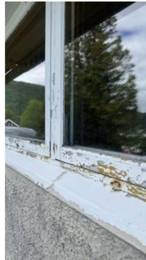
Eksempelbilde av slitasjegrad på vindu.
