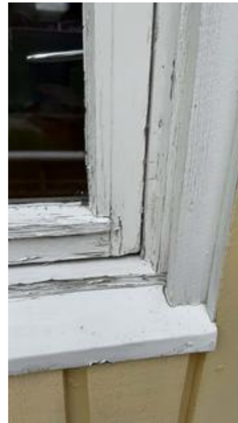
Eksempelbilde av slitasjegrad på vindu.
