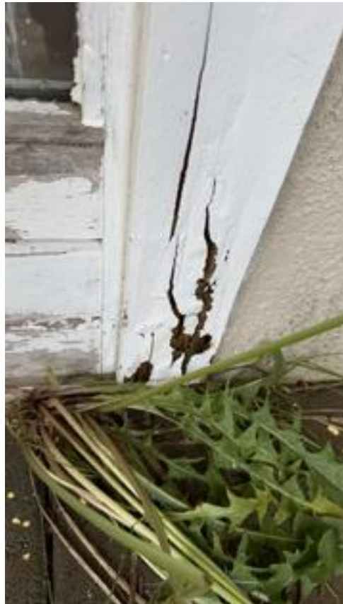
Eksempelbilde av råteskade og malingsavfluss.
