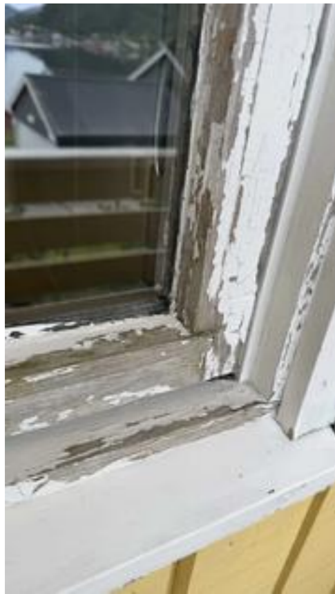
Eksempelbilde av slitasjegrad på vindu.
