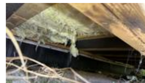
Eksempelbilde av manglende stubbloftsplate.
