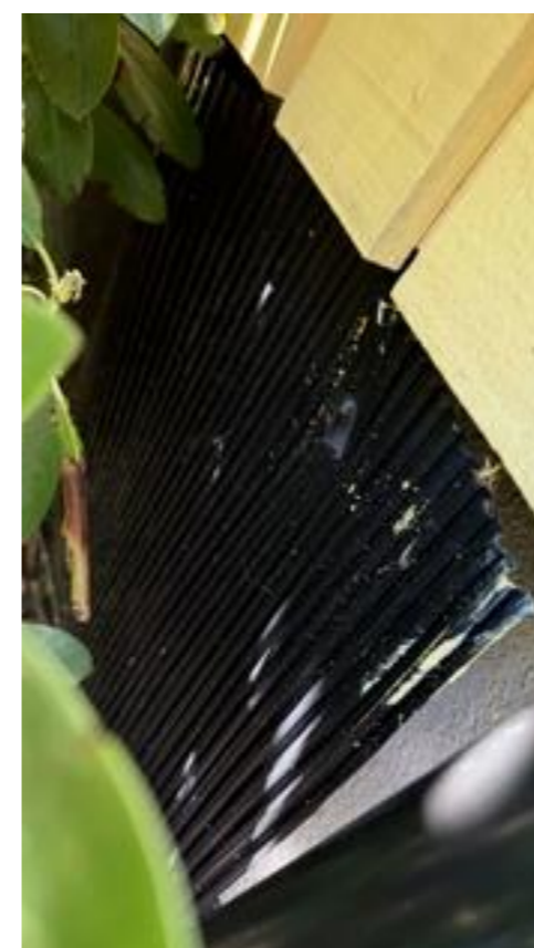
Eksempelbilde av manglende topplst på grunnmursplast.
