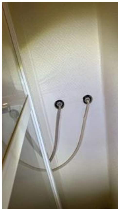
Eksempelbilde av utette gjennomføringer i våtsone.
