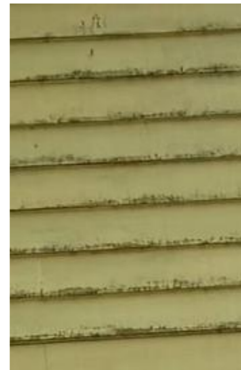
Eksempelbilde av slitasje/ svertesopp.
