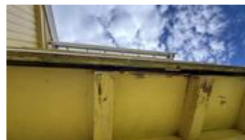
Eksempelbilde av fuktmerker.
