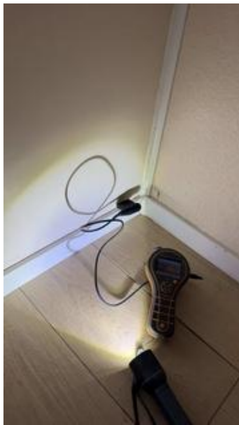
Eksempelbilde av høyt fuktinnhold ved fuktmåling i plater på vegg.
