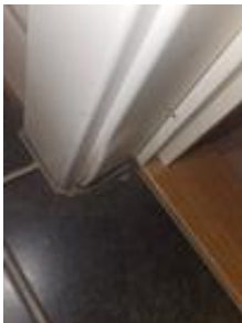
Fuktskade på utforing ved badedøren
