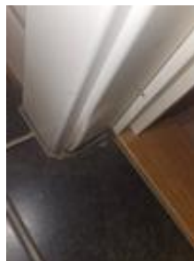
Fuktskade på utforing ved badedøren
