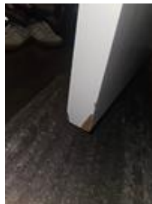
Skade på dørbladet, vaskerom
