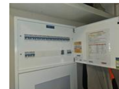
Sikringskap med automatsikringer og kursfortegnelse
