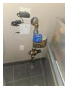
Stoppekran, måler og reduksjonsventil for vann
