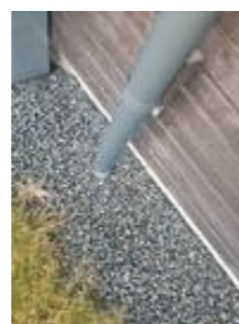
Takkvannet ledes til rør i grunnen
