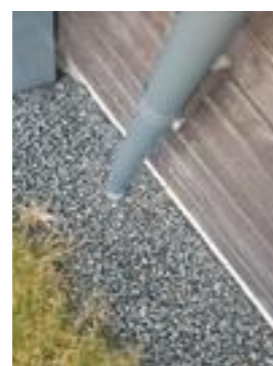
Takkvannet ledes til rør i grunnen
