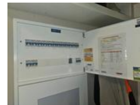
Sikringsskap med automatsikringer og kursfortegnelse
