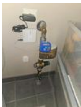
Stoppekran, måler og reduksjonsventil for vann
