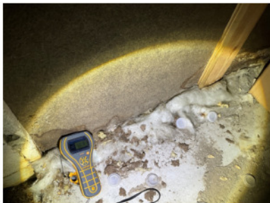
Skade i nedkant veggplater
