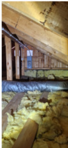
Det er ikke montert vindsperre i gavlvegg.
