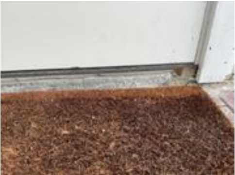
Ikke fugetetting eller beslag under sidedøren mot garasjen
