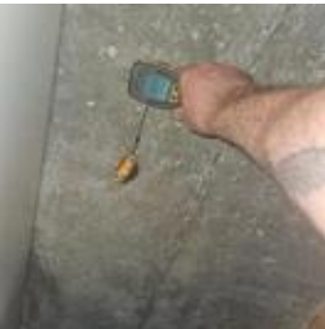
Fullt utslag på fuktindikator ved søk på betongvegg i boden
