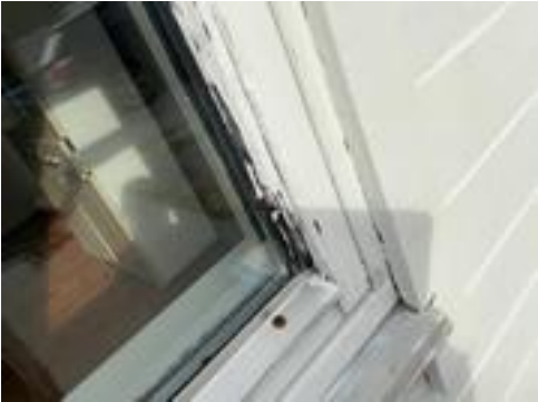
Fuktskade på glasslisten, slitasje på karmen
