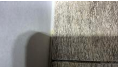
Sprekk i fuger.
