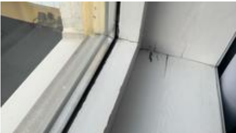
Oppsprekking i vindusforing.
