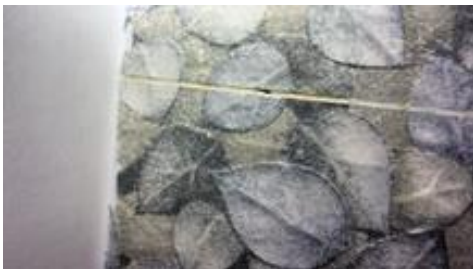
Sprekk/åpning i fuge.
