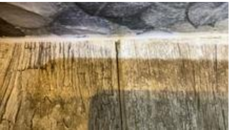
Sprekk i fuger.
