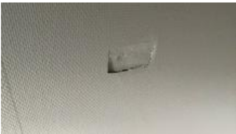
Skade på vegg i soverom.
