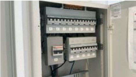
Sikringskap med automatsikringer.
