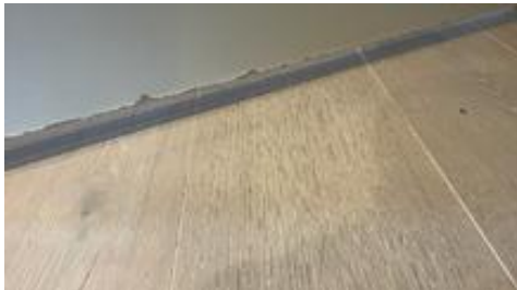
Dør til bad med flassing i nedre del.
