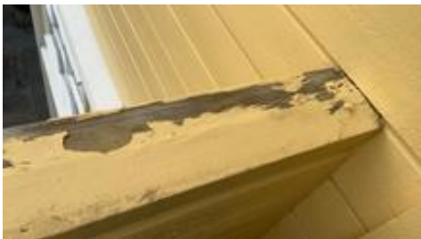
Slitasje på rekkverk.
