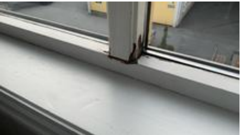
Vinduspost med avflassing.
