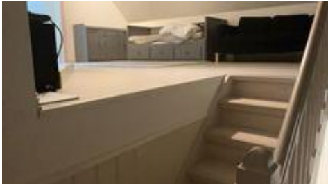
Manglende rekkverk på loft.
