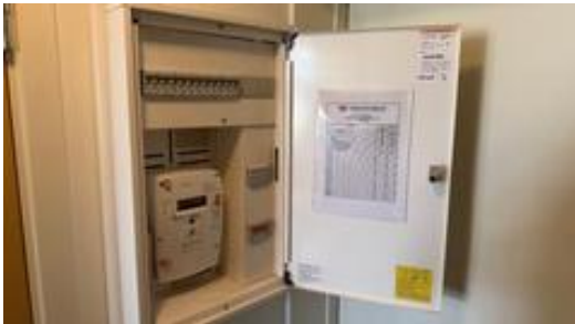
Bildet viser sikringsskapet for det elektriske anlegget.
