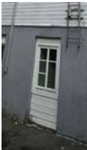
Utvendig listing av vinduer er ikke fagmessig utført.
