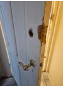
Enkelte av innvendige dører har betydelige skader
