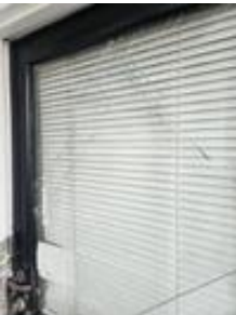
Det er påvist dører med punkterte eller sprukne glassruter. Det er påvist dører som er vanskelig å åpne eller lukke.
