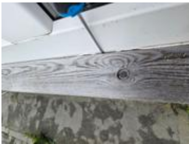
Montering av vannbrett på vinduer er ikke fagmessig utført.
