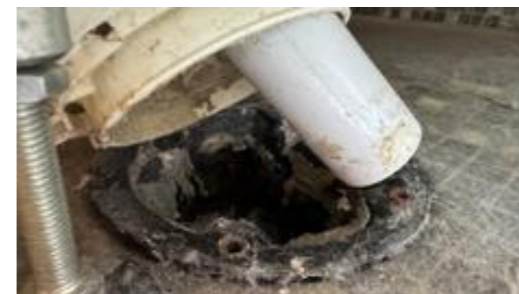
Slukens mansjett er løs fra sluk (mangler skruer)
