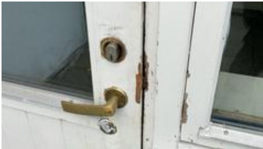
Skade i karm til dør mot byslag/vindfang i underetasje
