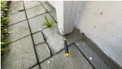
Råte i nedre ende av søyle under tilbygg.
