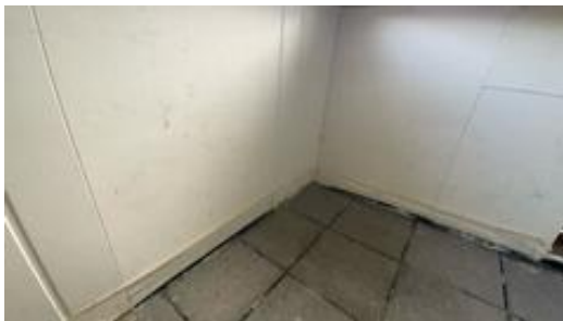
Det er benyttet himlingsplater som er montert på vegger i byslag/vindfang.
