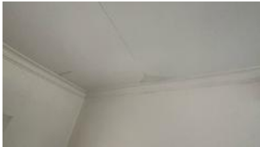
Fuktmerker i himling innenfor inngangsdør i 1.etasje.
