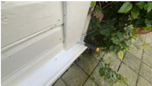
Råte i nedre ende av hjørnebord.
