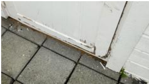
Vær og aldringsslitasjer i utvendig overflate på dør.
