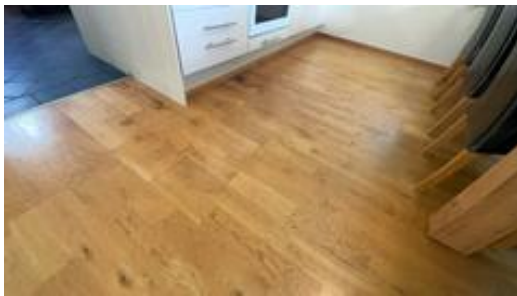
Skjevt gulv i 2.etasje.
