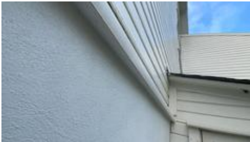
Det er ingen form for luftespalte bak kledning.
