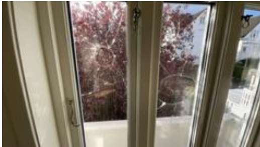
Knuste glass til vinduer i soverom i 2.etasje.
