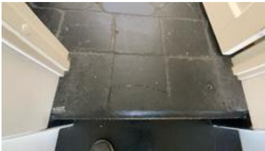
Sprukket flis i 2.etasje.
