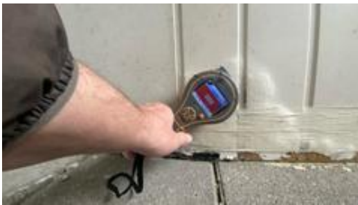
Fuktmerker og utslag på gulv i vegger i byslag underetasje.
