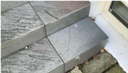
Sprekker i fliser.
