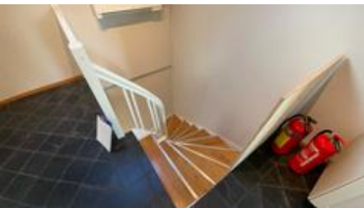
Det mangler håndløper på vegg i innvendig trapp.
