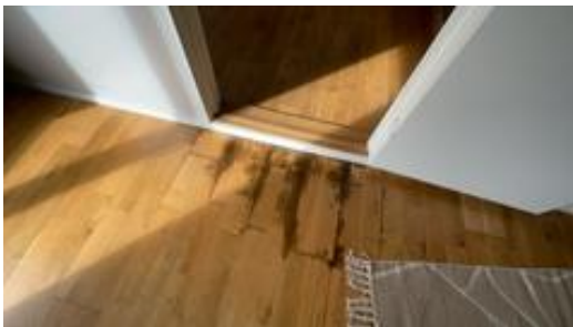
Fuktskader i parkett i 2.etasje.
