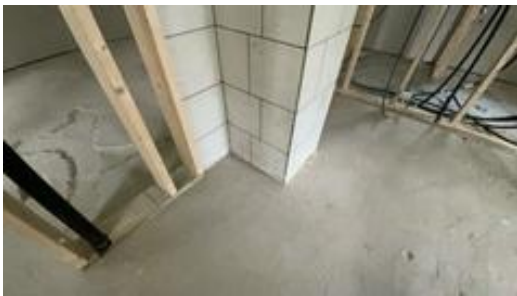
Det er ikke tilgjengelig sotluke i underetasje.
