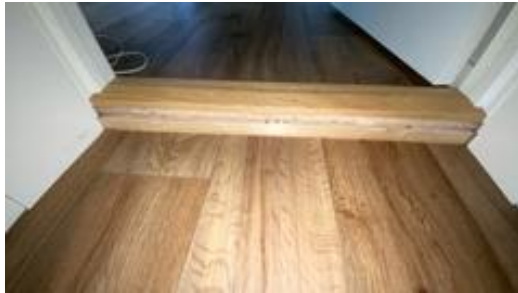
Det mangler terskellist mot dør.
