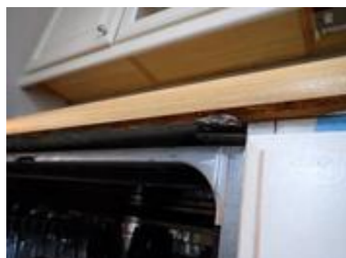
Swelling på underside av benkeplate ved oppvaskmaskin.
