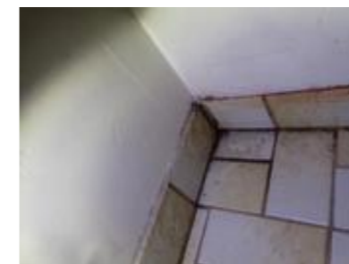
Et felt med manglende våtromstapet på vegg og svertesopp/missfarget silikonfuge.
