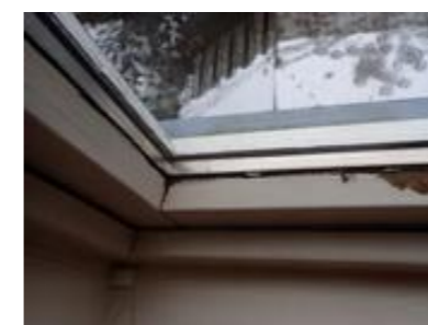
Eksempel på innvendig malingsavflassing.
