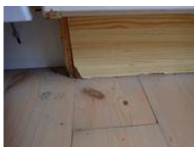
Swelling på sokkellist ved oppvaskmaskin.
