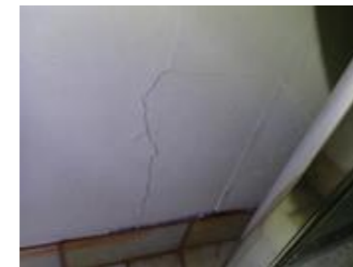
Manglende våtromstapet på vegg.
