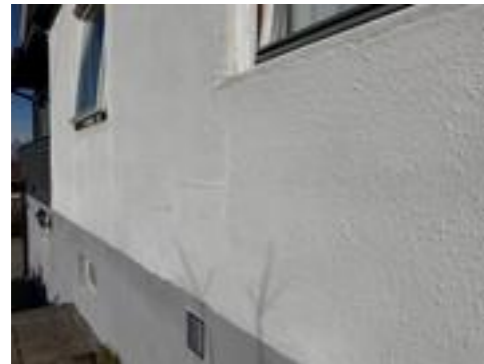
Riss/mindre setningssprekker i flere vegger
