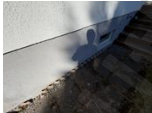
Asbestplater langs grunnmur og opprinnelige dreneringsforhold.
