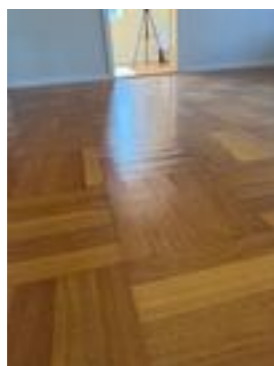
Eldre fuktskade på parkett i hovedstue
