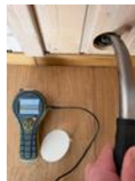
Entre. Målt opptil 18 % med Protimeter MMS 2 og pigger i svill (hvit treverk) i vegg ved hulltagning.
