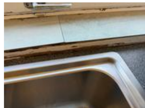
Fuktslitt område ved kjøkkenbenk/kran
