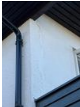
Sprekker i mur ved balkongdør i stue, 1 etg.
