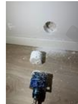
Ulovlig brannfarlig isopor på noen innvendige vegger i Uetg
