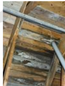
Fuktskjolder på undertak, kaldtloft
