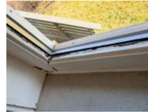
Flere eldre slitte vinduer-noen punkterte
