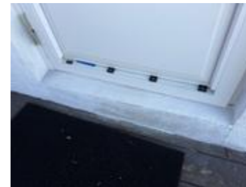
Manglende glasslist til felt i en balkongdør.
