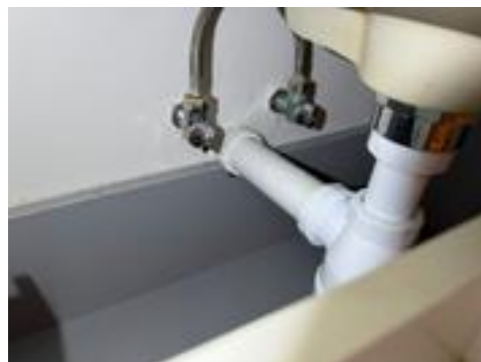
Rørpropplegg i servantskap UNDERETASJE > BAD
