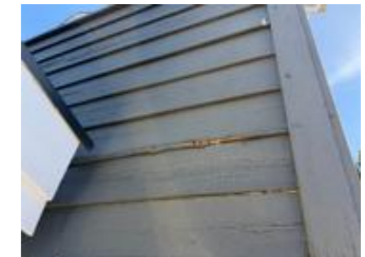
Råte i del av balkongrekkverk
