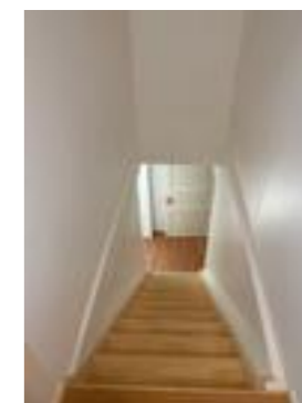
Manglende håndløpere i trappen.
