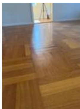
Eldre fuktskade på parkett i hovedstue
