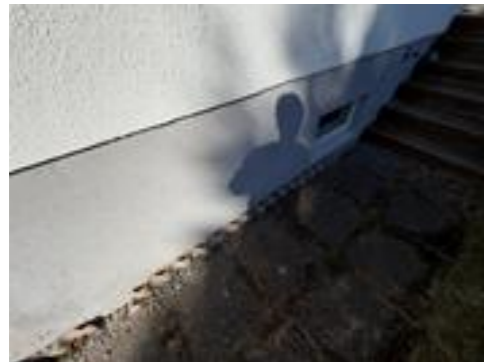
Asbestplater langs grunnmur og opprinnelige dreneringsforhold.
