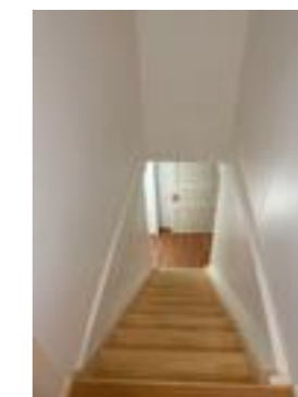
Manglende håndløpere i trappen.
