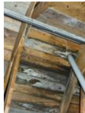
Fuktskjolder på undertak, kaldtloft
