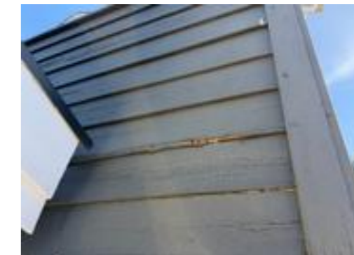
Råte i del av balkongrekkverk
