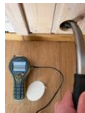
Entre. Målt opptil 18 % med Protimeter MMS 2 og pigger i svill (hvit treverk) i vegg ved hulltagning.
