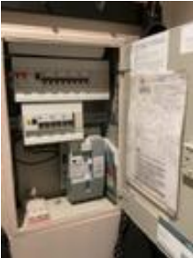
Sikringsskap med automatsikringer og kursfortegnelse
