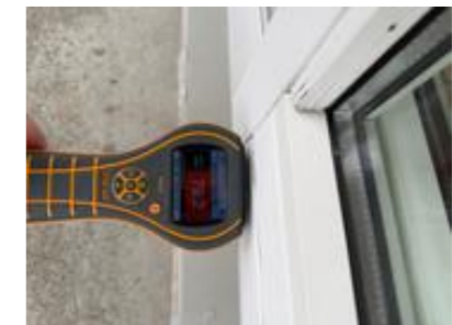
Høyt fuktnivå i nedre del av skyvedør.
