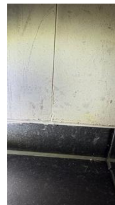
Eksempelbilde av glippe i skjøt til baderomsplater.
