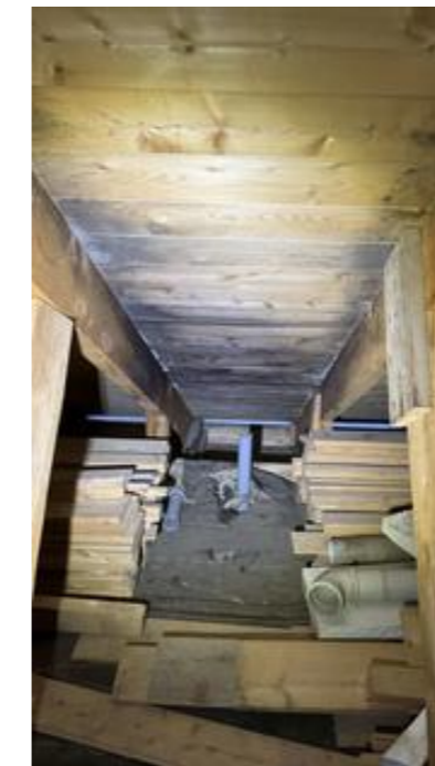
Eksempelbilde av fuktmerker i taktro.
