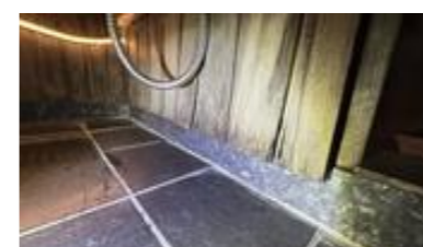
Eksempelbilde av fuktskadet trepanel.
