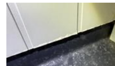
Eksempelbilde av svellinger/ malingsavflass i bunn av panelplater.
