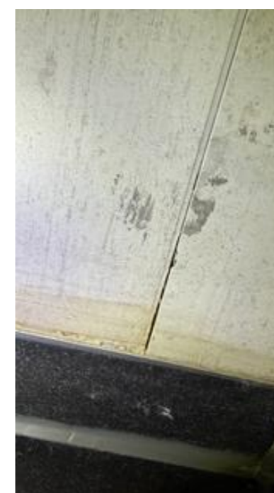
Eksempelbilde av glippe og skade i skjøt til baderomsplater.
