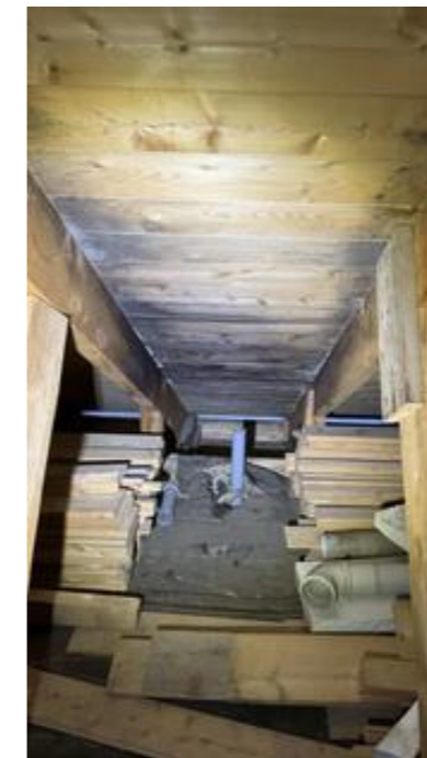
Eksempelbilde av fuktmerker i taktro.
