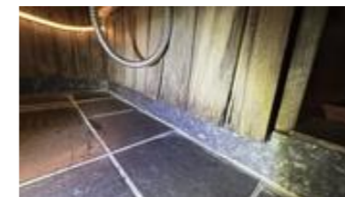
Eksempelbilde av fuktskadet trepanel.
