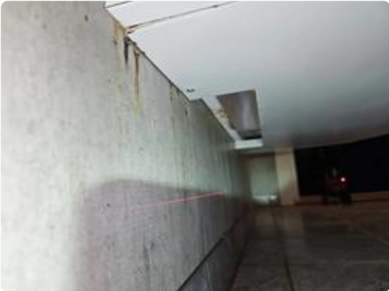
Tidligere lekkasje har gjort at innredning har svellet noe opp
