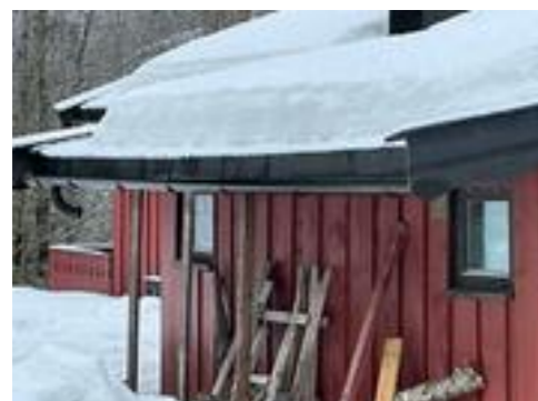
Feil fall takrenne.
