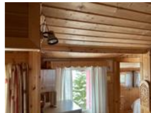
Noe skjevhet innvendig.
