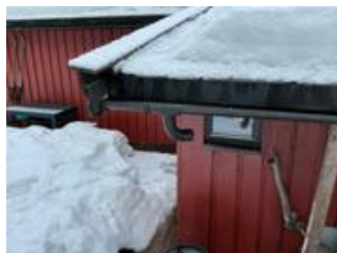
Mangler nedløp og utkaster ledes inn mot hytte.
