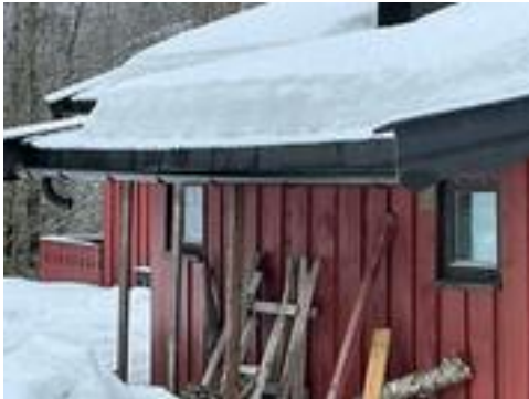
Feil fall takrenne.
