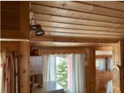
Noe skjevhet innvendig.
