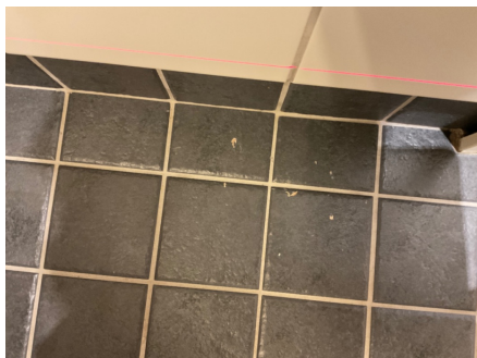
Småskader/sprekker i fliser
