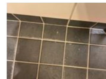
Småskader/sprekker i fliser
