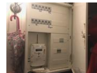
Sikringskap er plassert i gang 1. etasje.
