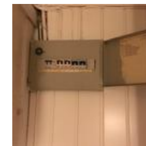
Sikringspanel i sokkelleilighet.
