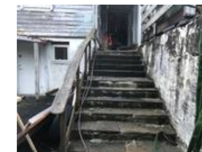
Det er forvitring og skader i betongtrapp.
