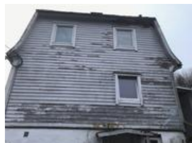
Fukt og råteskader i bordkledning, tiltak må iverksettes.
