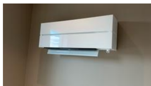
Luft til luft varmepumpe
