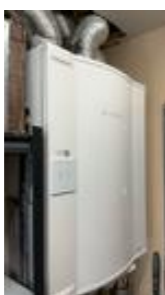
Balansert ventilasjon med varmegjenvinner
