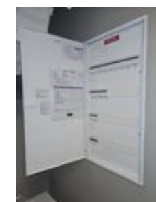
Sikringskap med automatsikringer og kursfortegnelse
