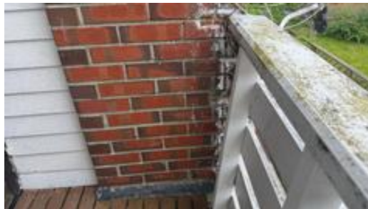
Rekkverk er ute av stilling i 2.etg
