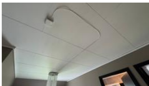
Kobling og kabling er utført som egeninnsats.
