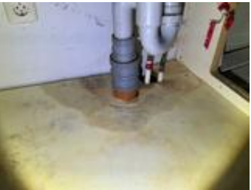
Eldre fuktmerker under kjøkkenvasken.
