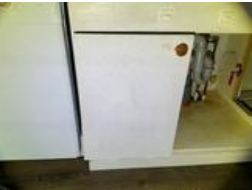
Svelling i innredningen.
