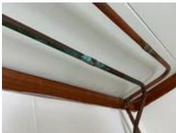
Korrosjon på vannrør.
