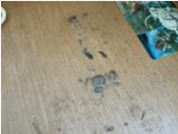
Hull og skader i vinylbelegget.
