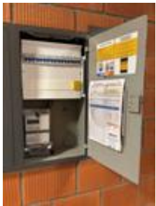
Elskap, plassert i felles trappegang.
