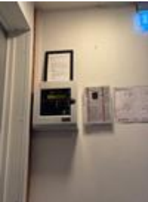
Felles brannvarslingsanlegg i bygget
