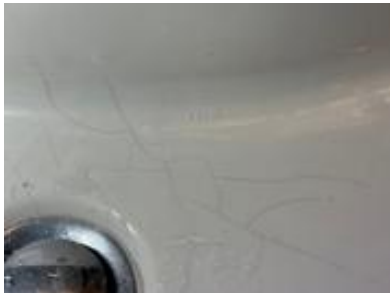
Krakkelering/småsprekker nede i servant
