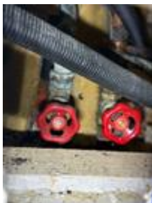
Stoppekraner langt inne i vegg sitter
