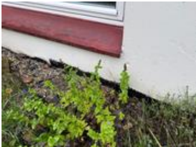
Grunnmursplast er ikke klemt inn til grunnmur med topplst.
