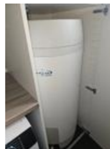
Varmtvannstank i et skap på badet
