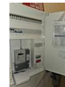
Sikringskap med automatsikringer og kursfortegnelse
