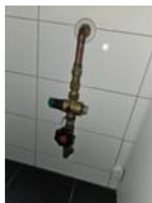
Stoppekran og reduksjonsventil for vann
