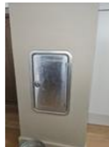
Pipe og sotluke på stue / kjøkken
