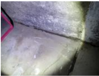
Synlig fukt i nedre del av mot vegg/grunn i kjellerbod som ligger i område der terreng heller inn mot boligen.
