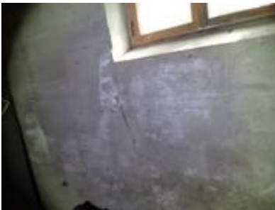
Sprekk i grunnmur ved vindu.
