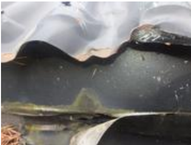
Skade og rust i taktekking
