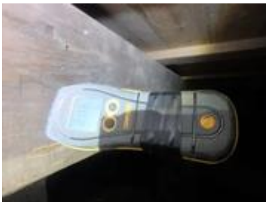
Høyt fukttinnhold i treverk.
