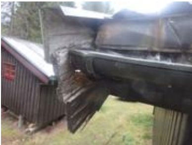
Råte i vindskier.
