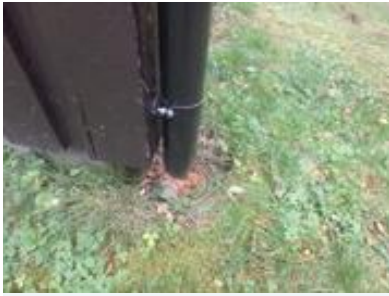
Taknedløp uten utkast ut fra grunnmur.
