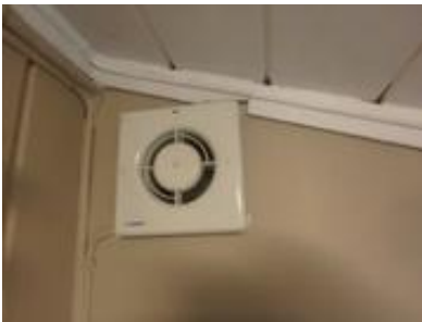
Avtrekkvifte over stekesone.
