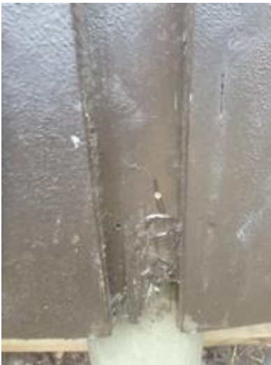
Mindre skade i kledning.
