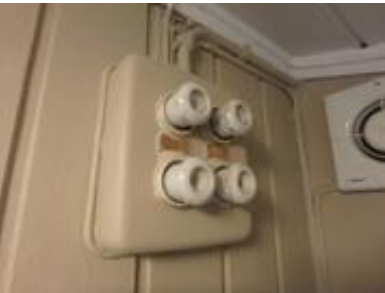
Sikringstavle på kjøkken.
