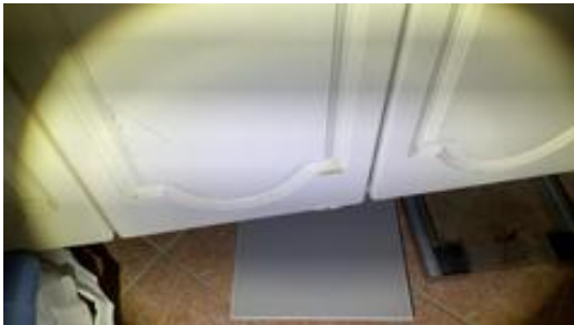
Fuktskader på dører.
