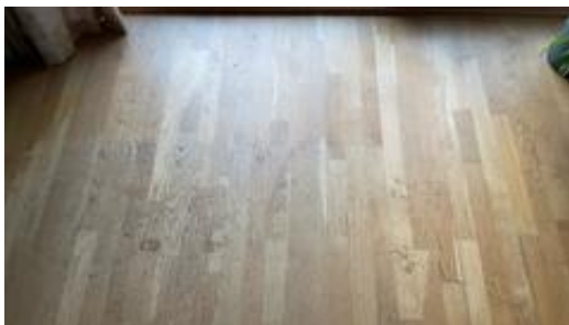
Bruksslitasjer på gulv, her i stue.
