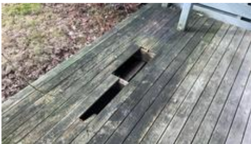
Mangler av enkelte terrassebord.
