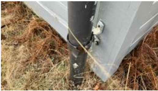
Rust på festklammer for nedløpsrør.
