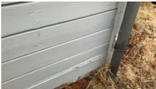
Råteskader på enkelte kledningsbord.
