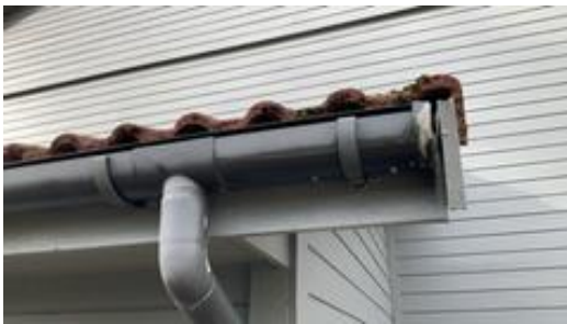
Sprikk/lekkasje fra takrenne.
