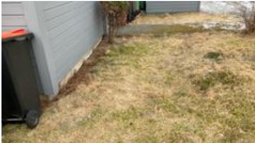
Terreng har fall mot mur, her på entresiden.
