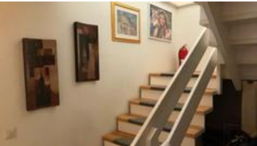
Ingen håndrekker/løpere på vegger.
