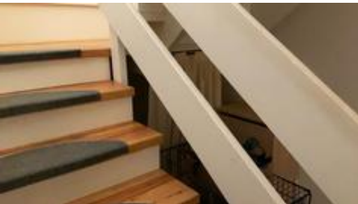
Større åpninger i rekkverk.
