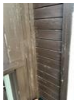
Kledningsbord som er værslitte
