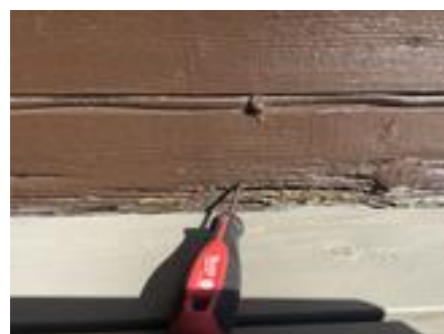
Sprekker i trevirke, påbegynne råteskader
