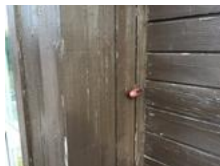
Mykt tretivkre, påbegynne råteskader
