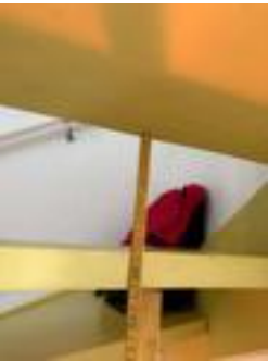
Åpning mellom trinn målt til 14 cm.
