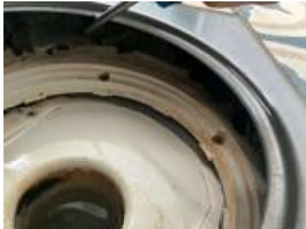
Slukmansjett som ikke er tilstrekkelig påført membran.
