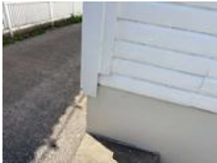
Kledning med spredt råte.
