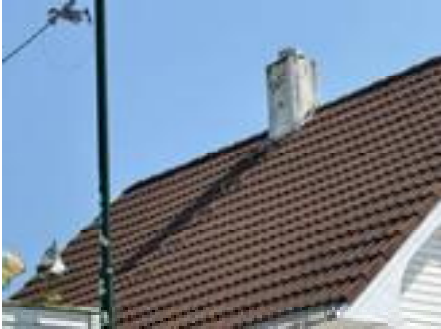
Manglende snøfanger på tak.
