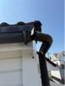
Nedløp som ikke er tilkoblet takrenne.
