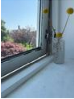
Vinduskarm med morkent treverk.
