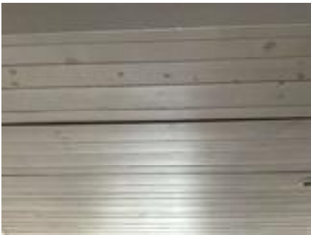
Bildet viser glipper i panel.
