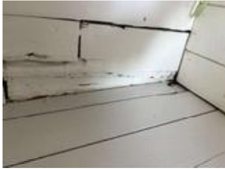
Trekonstruksjon med råte.
