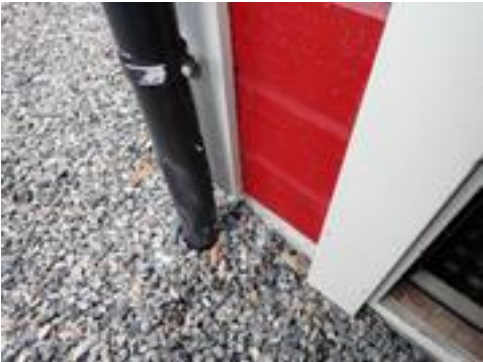
Skadet taknedløp ved garasje
