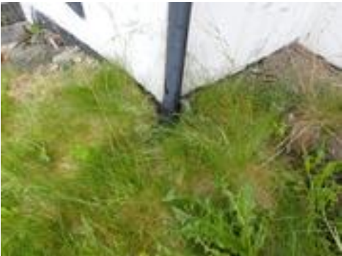
Avløp fra taknedløp ledet bort fra grunnmur
