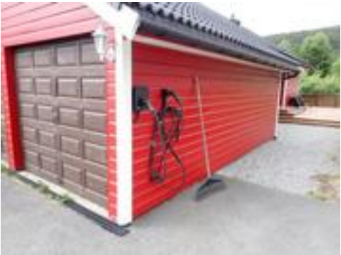
For lite avstand mellom kledning og bakkenivå
