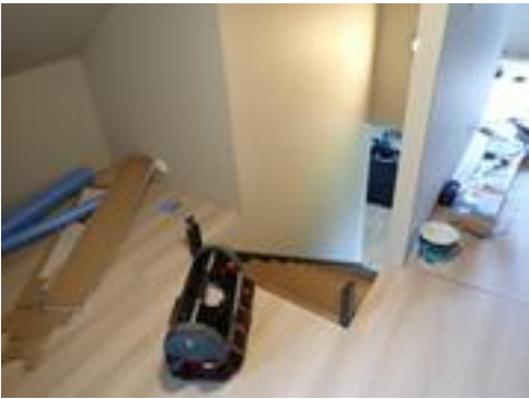
Ikke håndløper på vegg/rekkverk på trapp til loft.
