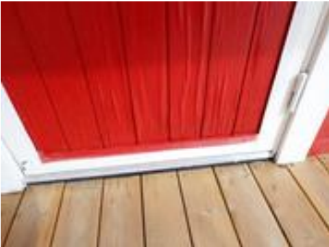
Skader trekledning under vindu balkongdør
