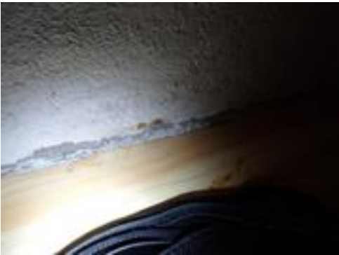
Noe mindre saltutslag innvenidg mur
