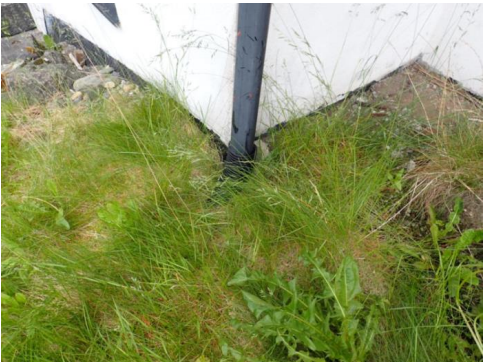
Avløp fra taknedløp ledet bort fra grunnmur
