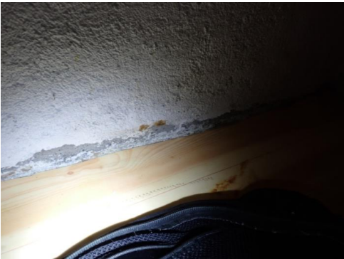
Noe mindre saltutslag innvenidg mur
