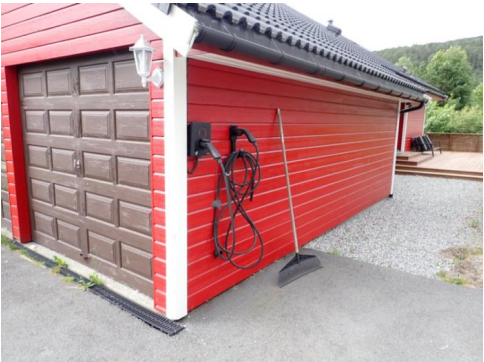
For lite avstand mellom kledning og bakkenivå
