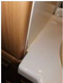
Skade på kanten av et skap ved siden av servanten
