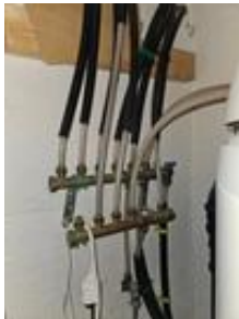
Rørfordeling uten skap, på vaskerommet
