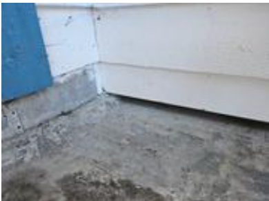
Ikke lufting langs nedre kant av kledningen, ved hoveddør
