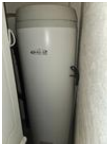
Varmtvannstank ca 300 liter fra 2008
