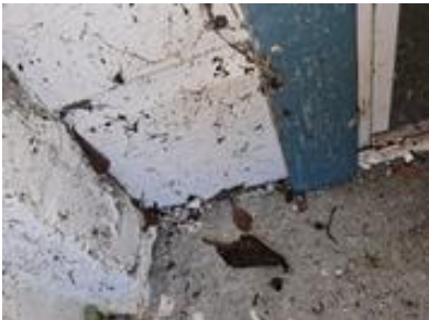
Ikke lufting langs nedre kant av kledningen, ved kjellerdør
