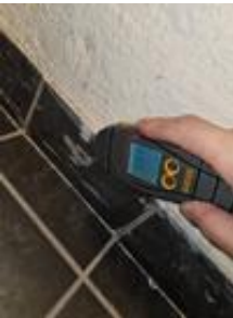
Søk med fuktindikator langs nedre del av veggen
