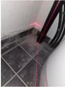
En sokkelflis mangler. Her synes det at membranen ikke er ført opp langs veggene.
