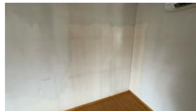
Det er fargeforskjell på veggen innvendig i stuen.
