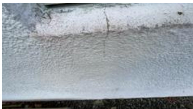
Det er observert riss i grunnmuren.
