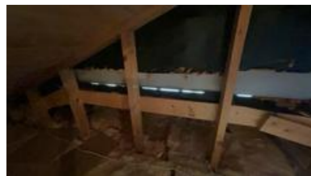
Åpning mellom utvendig beslag og taket på tilbygget.
