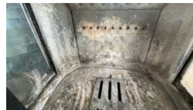
Sprekk i ildfast stein
