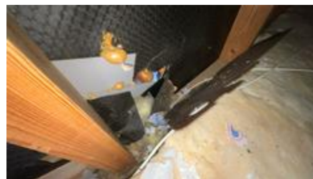
Hull ut i gavlveggen uten utvendig ventilrist.
