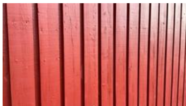
Det er tendenser til værslitt kledning.
