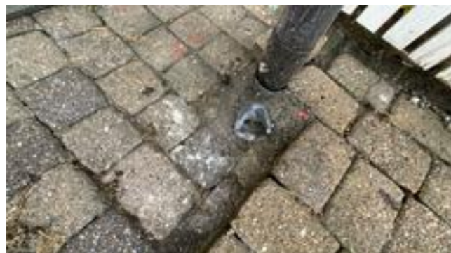
Nedløp renner ut ved grunnmur.
