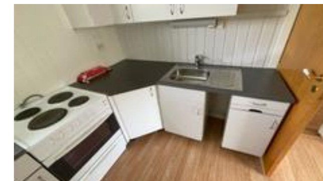
Kjøkkenet mangler tilkobling for komfyr
