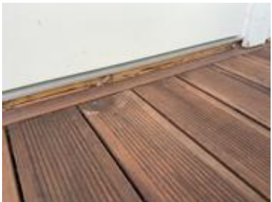
Det er ikke beslag i underkant av døren mot boden
