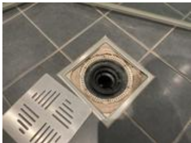
Plastsluk med slukmansjett og klemring, i dusjen
