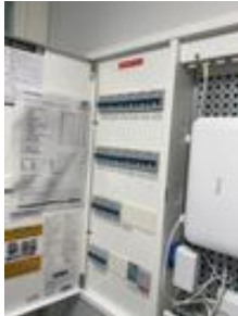
Sikringsskap med automatsikringer og kursfortegnelse
