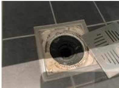
Plastsluk med slukmansjett og klemring, utenfor dusjen
