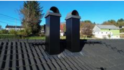
Pipetrekk av metall
