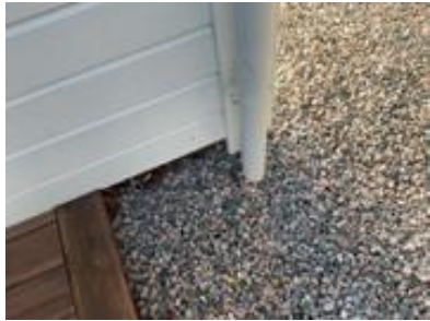
Takvannet ledes til rør i grunnen
