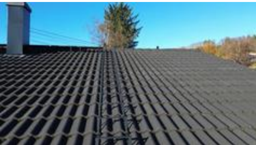
Fast monterte stigetrinn til pipen
