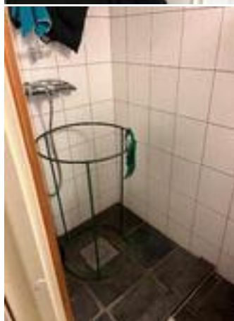
Del av bad i kjeller
