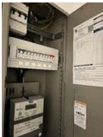
Ett av sikringsskapene
