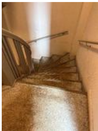
Innvendig trapp mellom første og andre etasje. Deler av overflatene er slitt.
