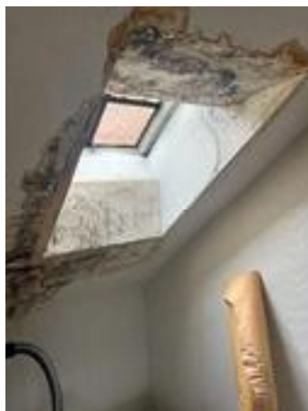
Kraftig misfarging etter fukt og kondens rundt takvindu på loft.
