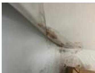
Misfarging etter fukt i himling under gradrenne.
