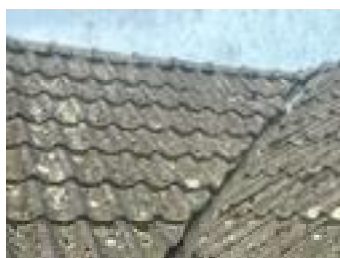
Det er setninger i deler av taksteinen.
