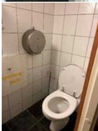
Del av bad i kjeller
