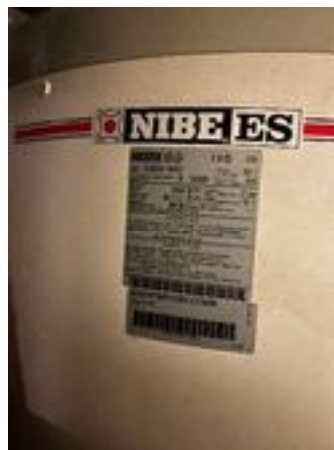
Det er en felles varmtvannsbereder for hele bygget, som er plassert i kjelleren
