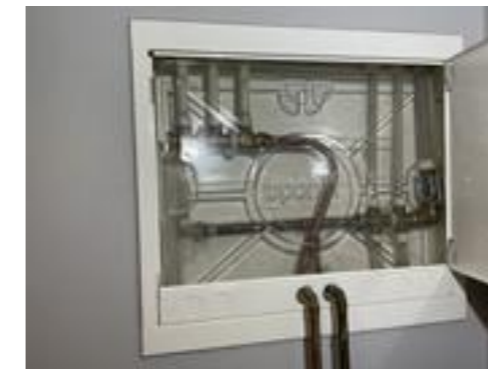
Fordelerskap med stoppekran.
