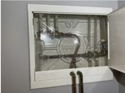
Fordelerskap med stoppekran.
