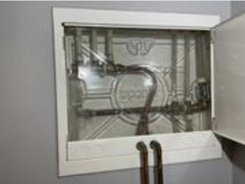
Fordelerskap med stoppekran.
