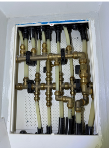
Rørskap i baderomsvegg hovedbad med 2 x stoppekraner-ikke merket
