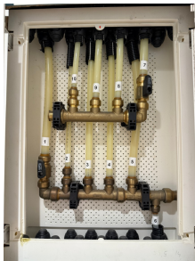
Rørskap i baderomsvegg liten hybel med 2 x stoppekraner
