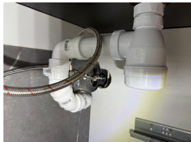
Rørapplegg i servantskap-stor hybel
