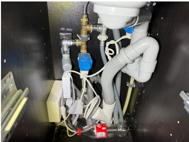
Røropplegg i kjøkkenbenk-liten hybel
