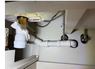
Røropplegg i servantskap
