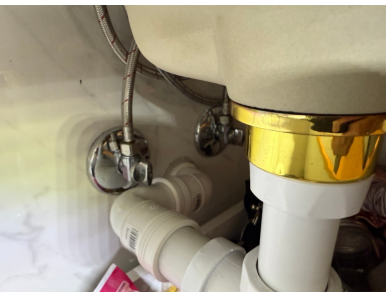
Rørapplegg i servantskap-liten hybel
