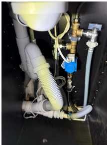
Røropplegg i kjøkkenbenk-stor hybel
