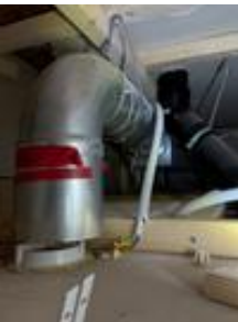
Ventil er ikke tilkoblet avtrekksrøret. (løs strømledning ligger i himling)
