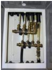
Rørskap i baderomsvegg stor hybel med 2 x stoppekraner
