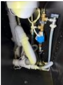
Røropplegg i kjøkkenbenk-stor hybel
