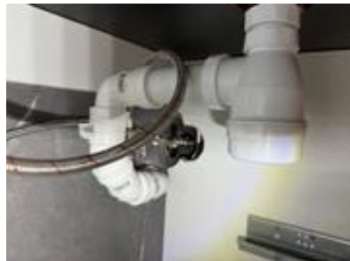
Røropplegg i servantskap-stor hybel
