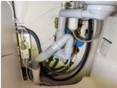
Røropplegg i kjøkkenbenk
