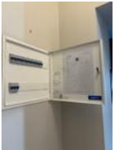
Automatsikringer med skap i stor hybel
