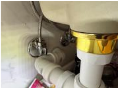
Røropplegg i servantskap-liten hybel
