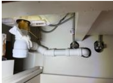
Røropplegg i servantskap
